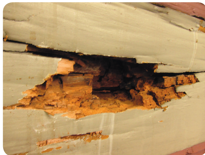
Lae puhastamise käigus leiti lae keskosa puidust kandekonstruktsioonilt puidu kahjustused.
